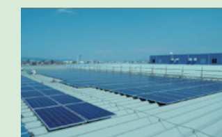
大阪中央工場屋上に設置された350枚のモジュール
