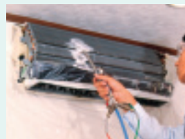
エアコンクリーニングの様子。
