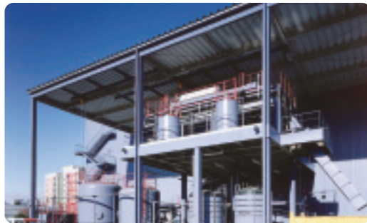
廃水処理設備
