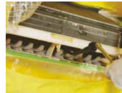
エアコンクリーニングの様子。
