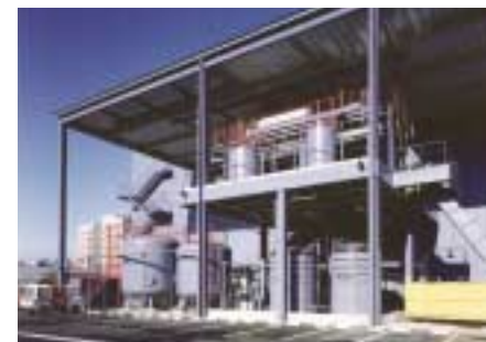
廃水処理設備（横浜中央工場）。
