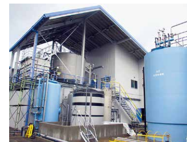
排水処理設備
